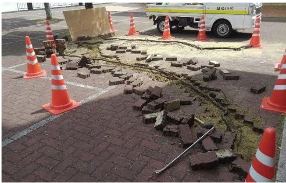
根上がりで舗装の修繕が必要になった例
