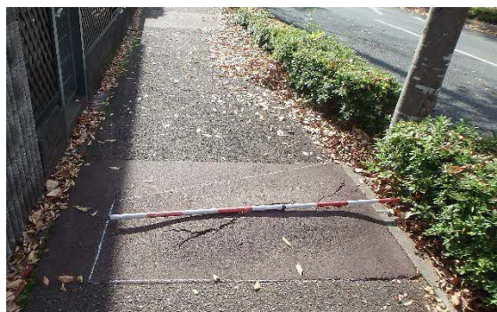
舗装が隆起しひび割れた例
