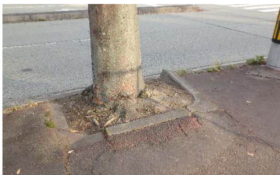
縁石や周囲の舗装を隆起させている例
